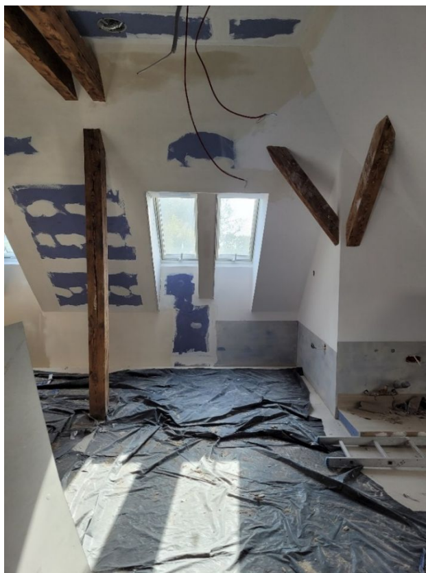
Ryc. 3. Świecie. Widok fragmentu wnętrza poddasza budynku widocznego na ryc. 2 podczas robót budowlanych (fot. autor)
